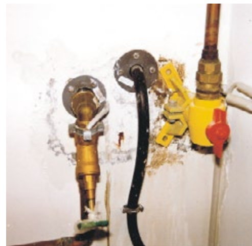
Abb. 108 undichte Hausanschlüsse sehr dicht aneinander gelegt
