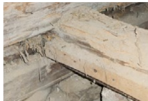
Abb. 3 Problemstelle Auflagerbereich für Fußschwelle und Balkenköpfe
