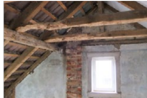
Abb. 2 nicht mehr tragfähige Kehlbalken (oben links) durch Schädlingsbefall
