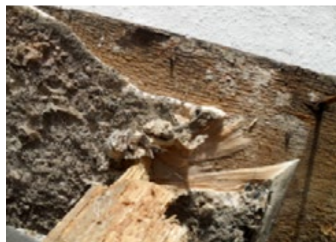
Abb. 1 Pilzbefall unter Fußbodendämmung
