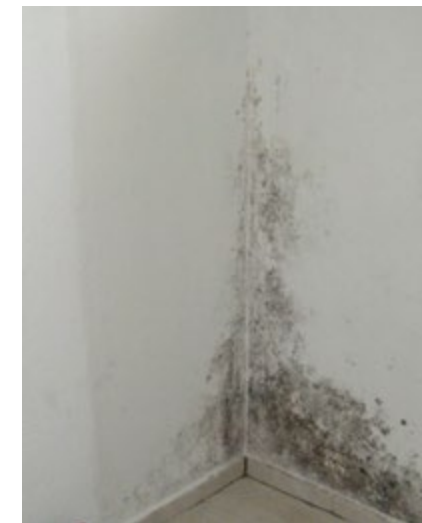
Abb. 7 Schimmelentstehung in einer Rauminnenecke aufgrund unzureichender Oberflächentemperatur
