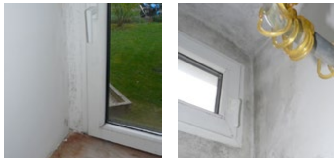
Abb. 92 / 93 Bildung von Stockflecken durch Kondensatausfall an den angrenzenden Wandoberflächen
