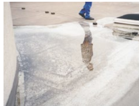
Abb. 50 Pfützenbildung auf einem Flachdach – Schäden an der Dichtungsbahn sind die Folge
