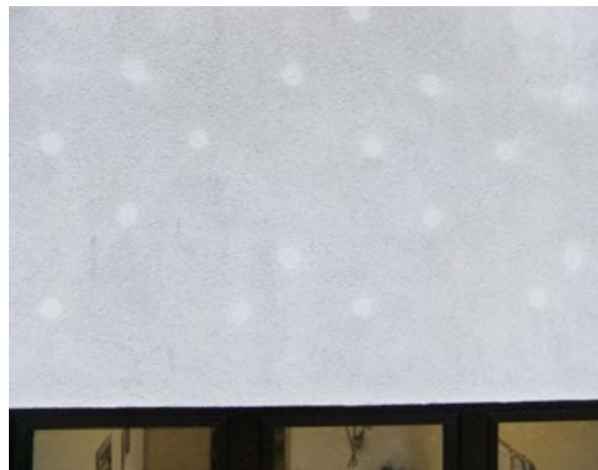
Abb. 72 Dübel des WDVS zeichnen sich deutlich auf der Fassadenoberfläche ab
