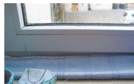
Abb. 6 starker Tauwasseranfall am Fensterrandverbund Glas-Rahmen
