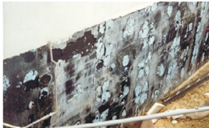
Abb. 112 Perimeterdämmung war nicht vollflächig verklebt. Wasser konnte hinter die Dämmebene gelangen, so dass die Dämmwirkung stark reduziert wurde.
