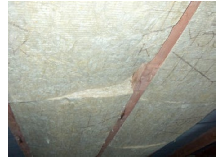
Abb. 27 zusammengedrückte Wärmedämmung zwischen den Sparren
