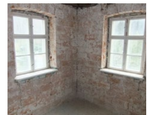
Abb. 90 Fenster im Bestand mit Einfach-Verglasung
