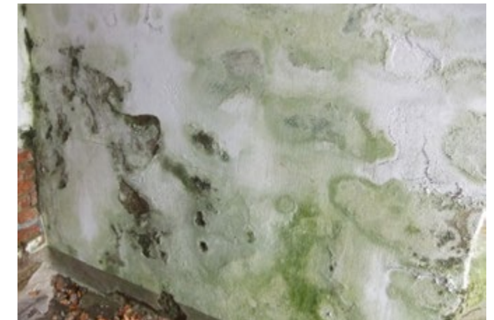
Abb. 60 extrem durchfeuchtetes Außenmauerwerk
