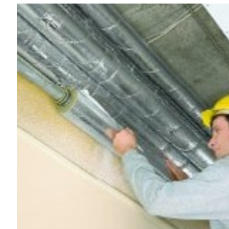
Abb. 104 Dämmmaßnahme an Wärmeverteilungsleitungen
