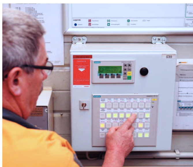
Marktleiter I. Silligmann am Bedienpanel der Gebäudeleittechnik. Energie- effizient steuert sie Heizung, Lüftung, Beleuchtung und weitere Verbraucher
