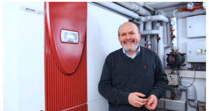
Die Wärmepumpe – Herzstück von Jerzy Timms Energiemanagement-System
