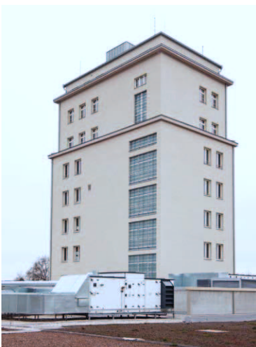
Lüftungsanlage auf der Nordseite hinter dem Hochhaus.
