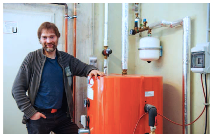
Ein Wärmespeicher gehört zum System der Wärmerückgewinnung.
