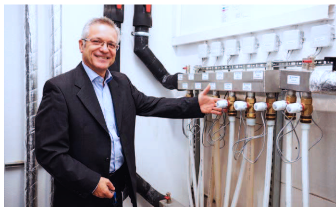
Jens Köhler am Verteiler für die effiziente Fußbodenheizung
