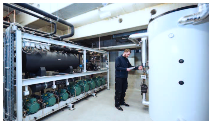
Kühlaggregate und Pufferspeicher für die Abwärme
