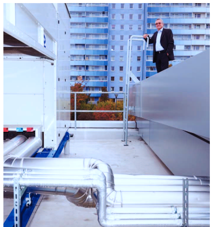
Heizen, Lüften und Kühlen mit einer zentralen Kälteanlage, LIDL-Filiale in Weißwasser (vgl. Seite 19)
