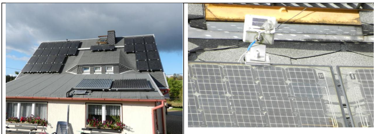
Bild 63: PVA Altenberg; rechts Detail mit Strahlungssensor (unbrauchbar wegen Ablösung der Schutzschicht)
