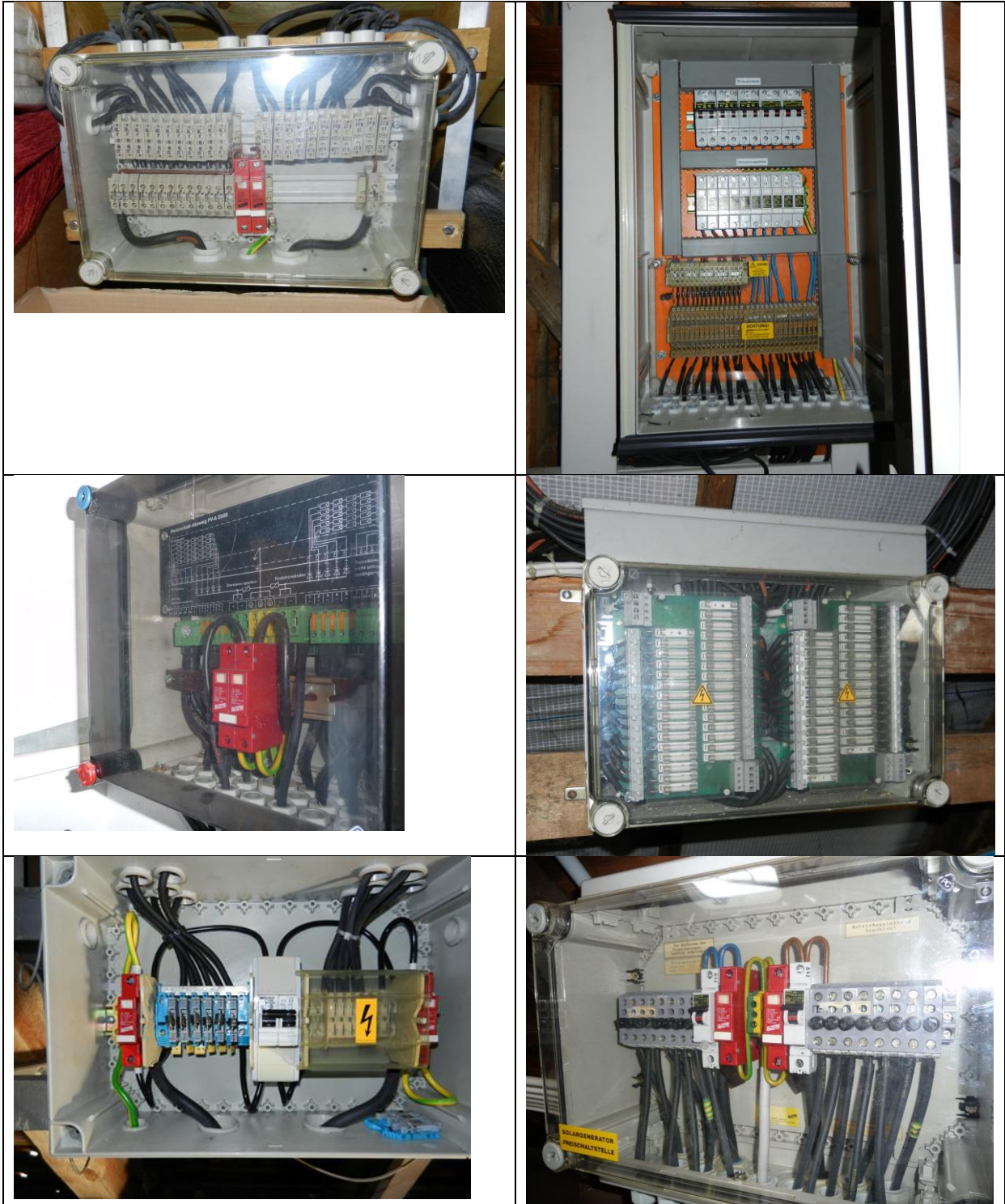
Bild 20: Beispiele von Generatoranschlusskästen (PVA Aue, PVA Chemnitz; PVA Freital I, PVA Dresden X; PVA Elsterheide, PVA Regis-Breitungen)
