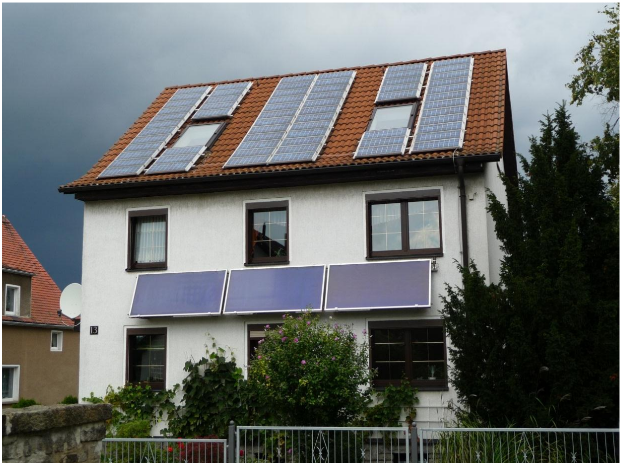
Bild 9: Typischer PV-Generator (Aufdachmontage, PVA Bautzen). An der Fassade sind zusätzlich Kollektoren einer solarthermischen Anlage montiert.
