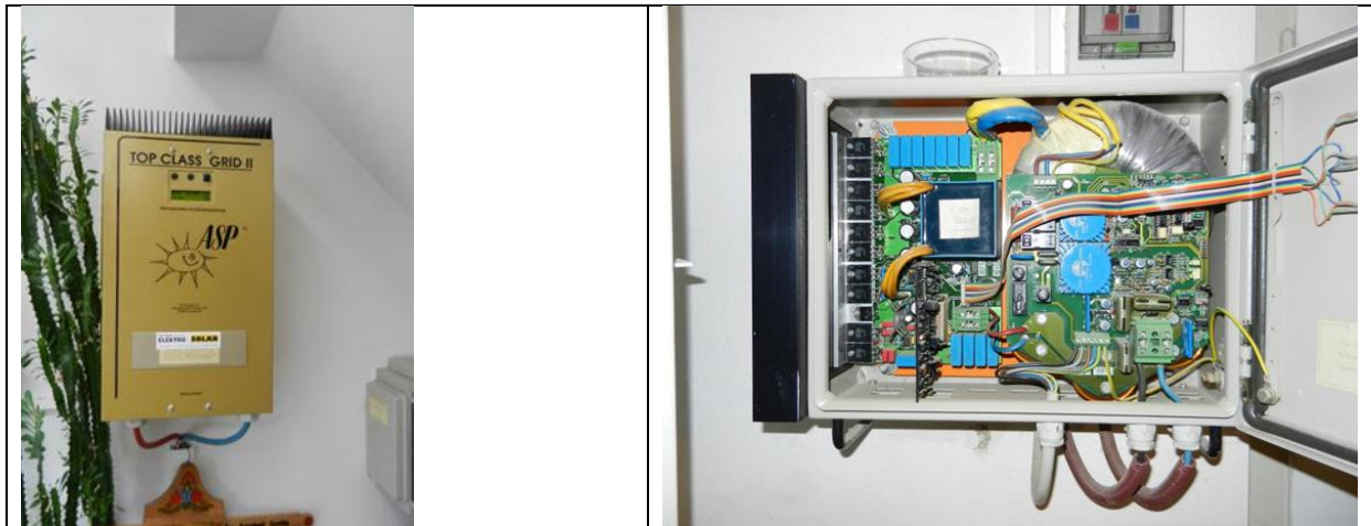
Bild 21: Fehlerfrei arbeitende Wechselrichter: TOP-Class Grid II (PVA Größschönauf) und NEG 1600 (PVA Limbach-Oberfrohna)
