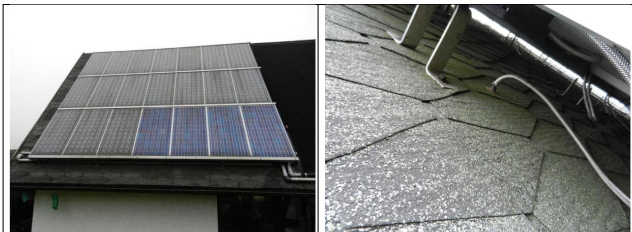
Bild 59: PVA Neustadt (Sachsen); rechts ummantelte Modulleitungen zum Schutz vor Marderfraß
