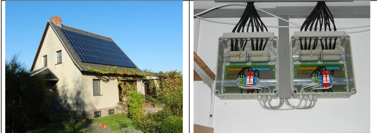
Bild 50: PVA Diera-Zehren; rechts Generatoranschlusskasten
